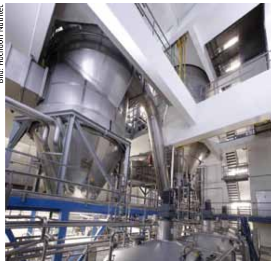
Der Sprühturm des Werks in Sulgen
